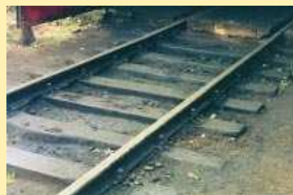
Fot. 1. Tory trakcyjne z charakterystycznymi zabrudzeniami podsypki smarem i olejami.
