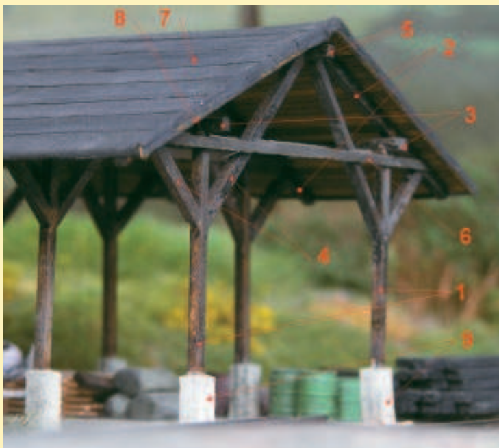
Fot. 4 Elementy konstrukcyjne drewnianej wiatry: 1) słupy; 2) krokwie; 3) płatwie; 4) zastrzały (miecze); 5) belka kalenicowa; 6) kleszcze; 7) połąc dachowa; 8) wiatrownica; 9) stopy fundamentowe
